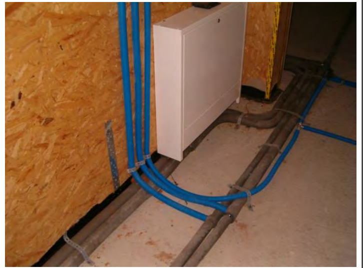
Heizkreisverteiler und Wasserleitung.
